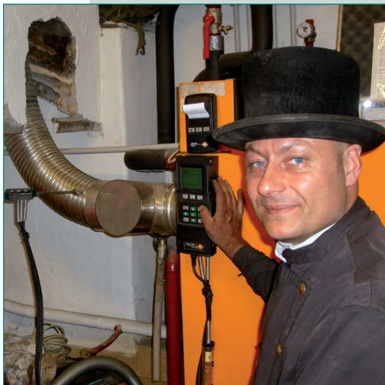
Photo Ralph Willig : Contrôle d'une chaudière fioul par le maître ramoneur Ralph Willig et mesure de son rendement.
